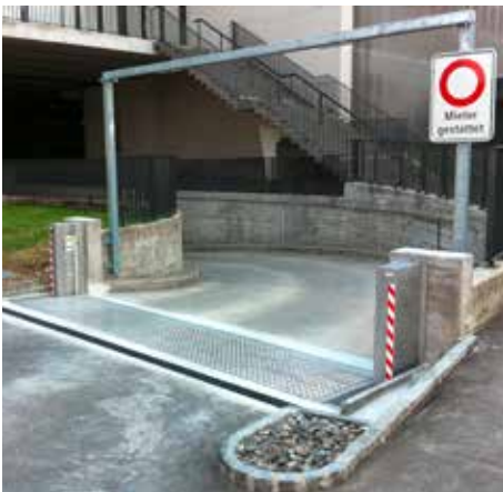
Barrière de rétention pour garages souterrains, centre commercial, Spreitenbach
